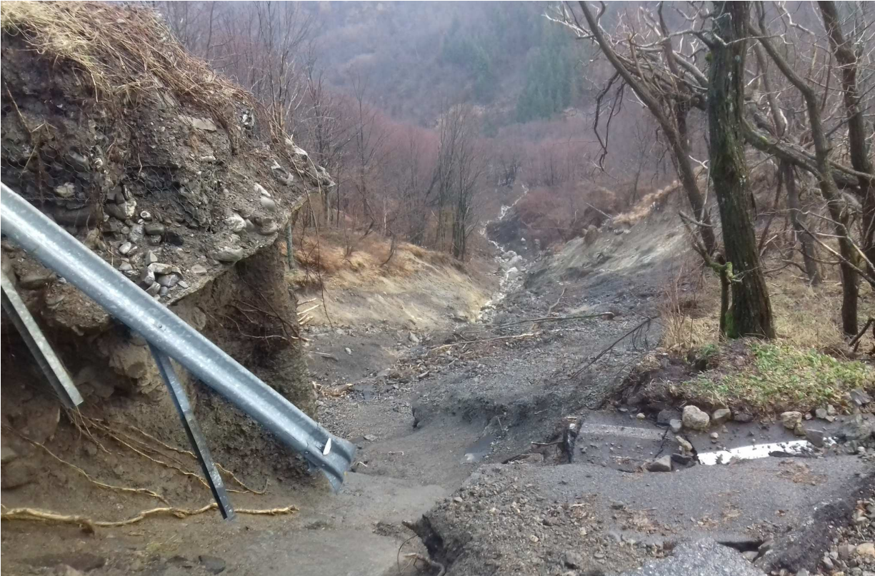
Foto 3 – Vista dal piano viabile del pendio di valle interessato dal movimento franoso.
