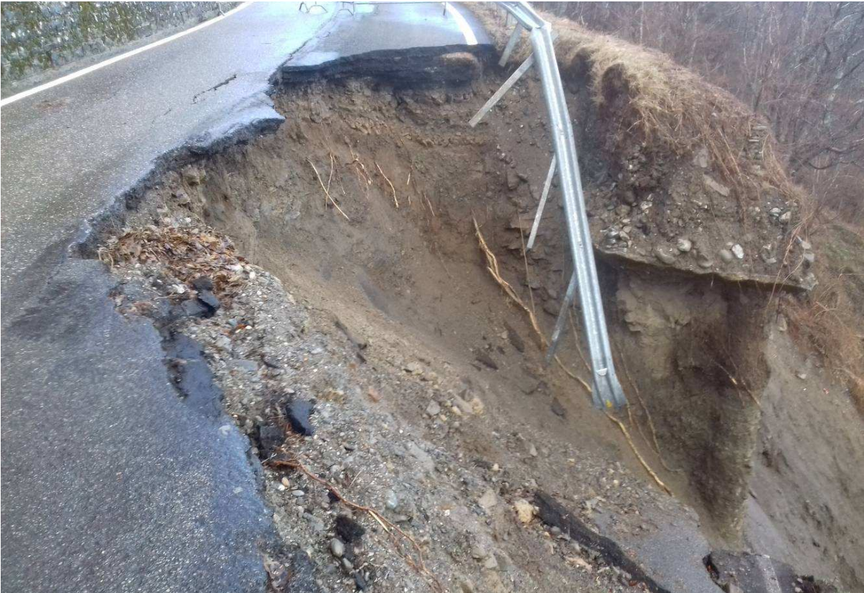
Foto 2 – Vista da sud del tratto interessato dal cedimento della sede stradale, si vede anche l'opera di sostegno realizzata nel 2002-2003.
