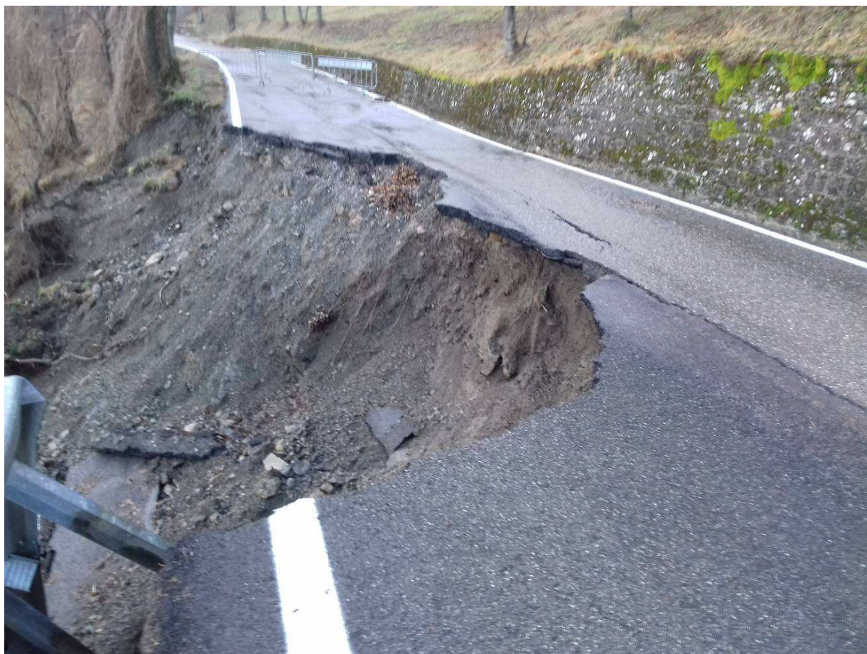
Foto 1 – Vista da nord del tratto interessato dal cedimento della sede stradale.
