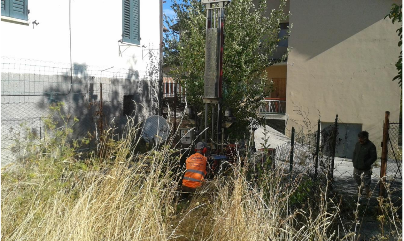
Prova penetrometrica in fase di esecuzione. Sullo sfondo l'edificio giallo della scuola "Rizzi"
