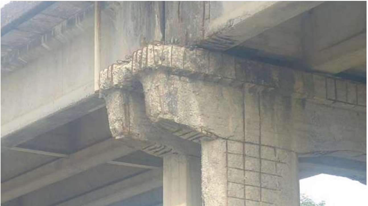
Figura 8 - Vista degrado trave pulvino
