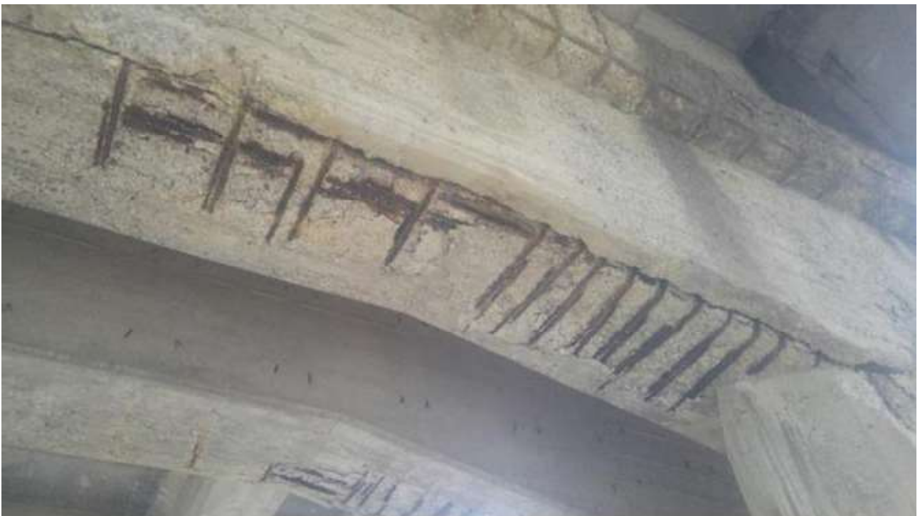
Figura 9 - Vista degrado intradosso trave pulvino
