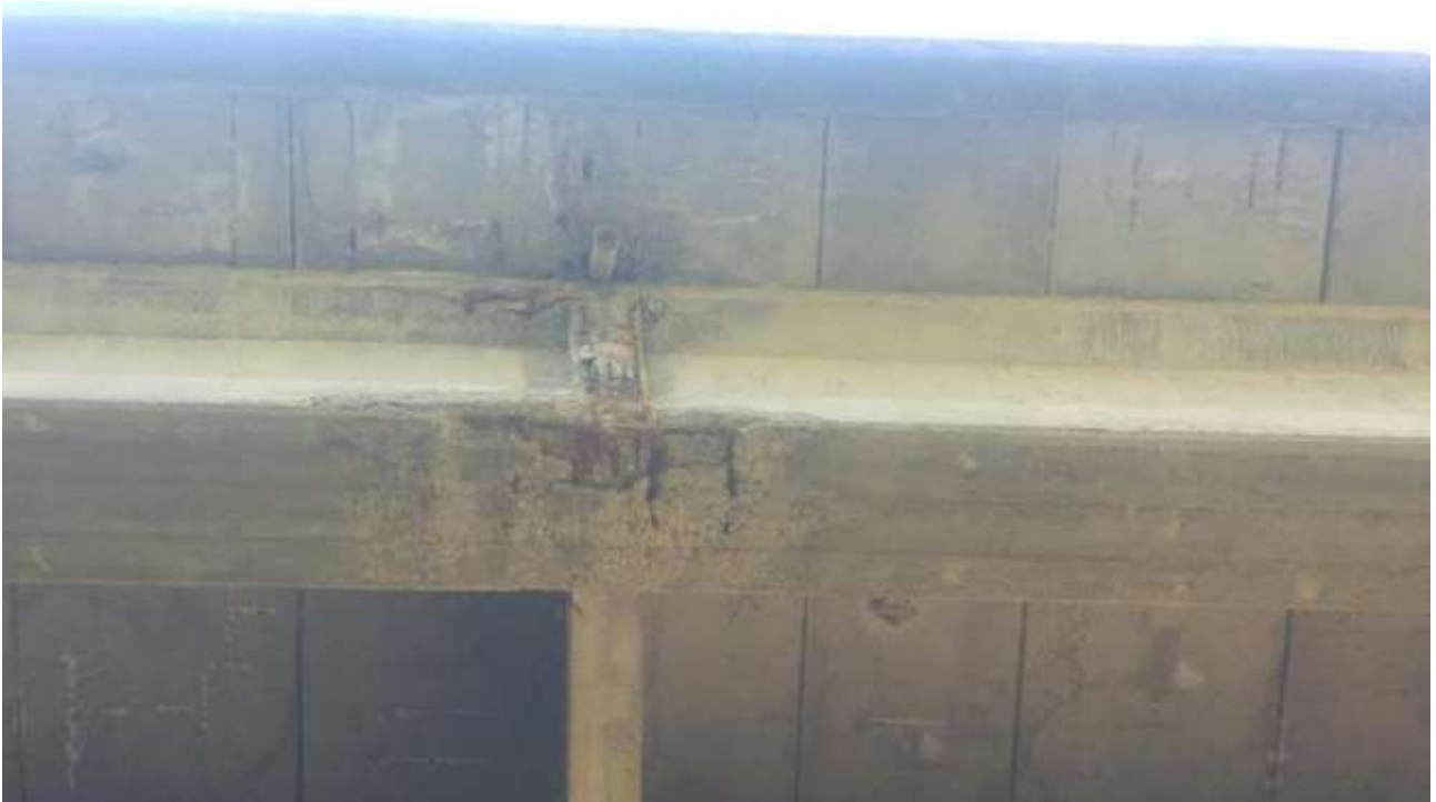
Figura 10 - Vista degrado di testata di traverso intermedio
