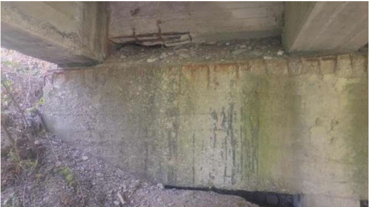
Figura 11 - Vista degrado spalle est e traverso terminale
