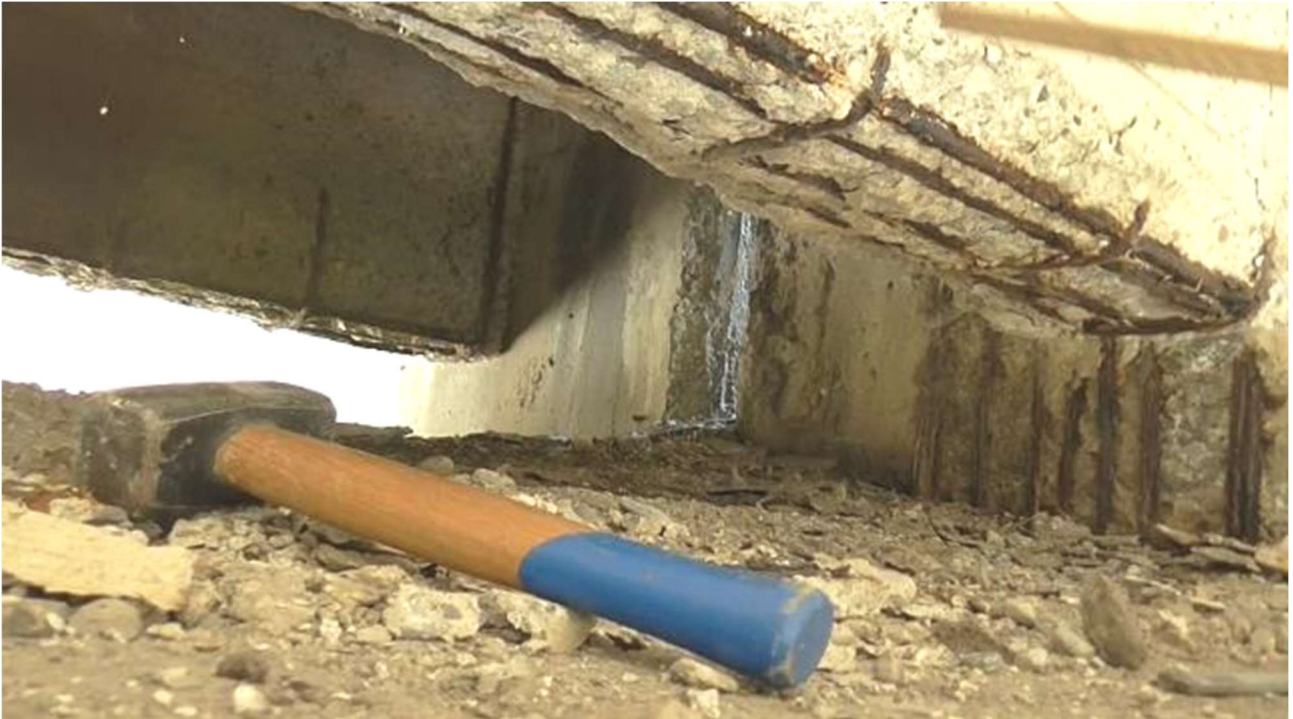
Figure 12 - Vista degrado trasverso
