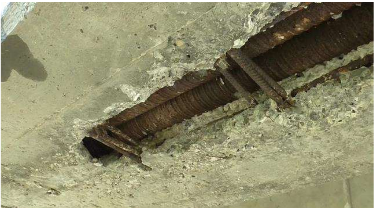
Figure 13 - Guaine ossidate dei cavi di precompressione
